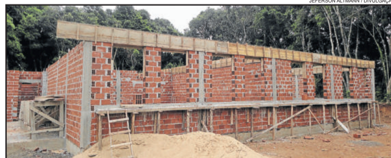
Primeiro Módulo do novo prédio da EMEF Bento Gonçalves segue com as obras no Bairro Boa Vista
