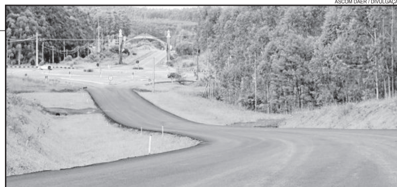
Estrada de Aterrados recebeu camada asfáltica em parte dos sete quilômetros de extensão
