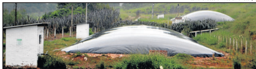
Biodigestores da UPL em Bom Retiro do Sul são utilizados como piloto na geração de biogás nas unidades da Cooperativa Languiru
