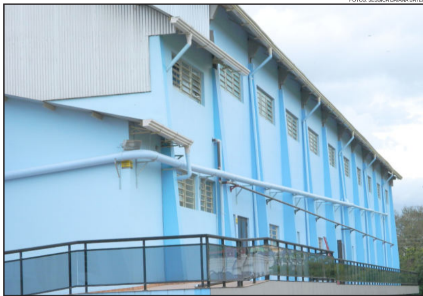
Captção de água da chuva é feita através de calhas instaladas no ginásio da associação
