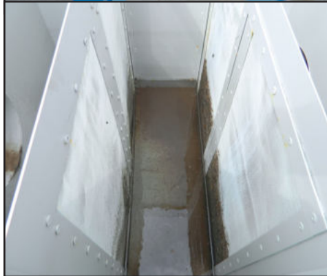
Sistema de filtragem da água das 3 cisternas de 300 mil litros de capacidade
