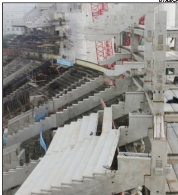
Para Ministério Público, há irregularidades nas obras da Arena Palestra do Palmeiras
