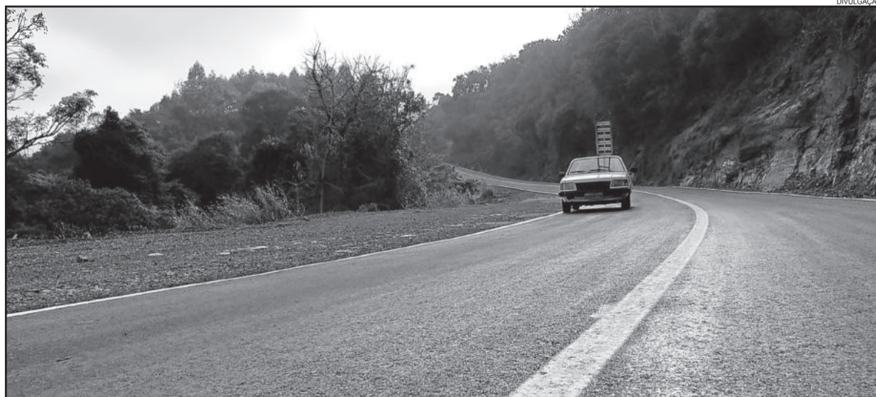
Atenção maior foi para o trecho onde no ano passado ocorreu o desmoronamento com queda de barreiras em que parte do asfalto cedeu em virtude das fortes chuvas
