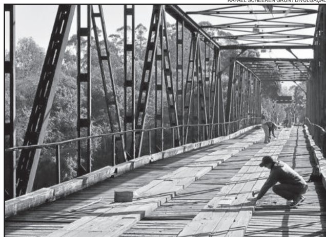
Ponte está interrompida para execução dos reparos
