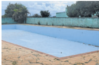
Área da piscina, que está vazia, segue em péssimo estado
