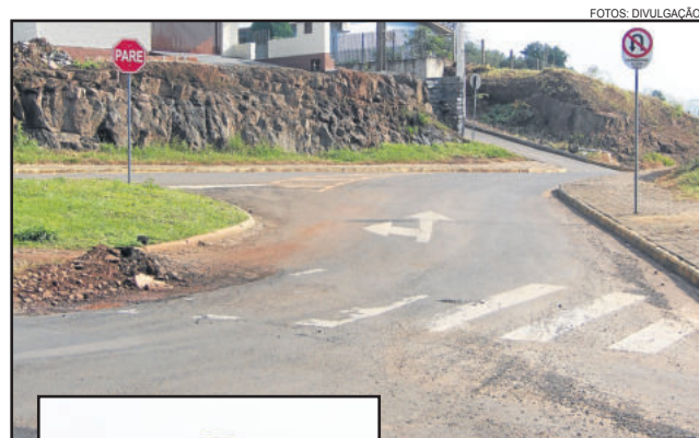
Rua apresenta avarias na pavimentação
