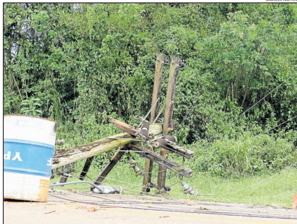
A estrada em Daltro Filho ficou bloqueada por poste que caiu e fios sobre a pista
