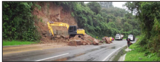
Queda de barreira no Km 64 da RSC-453
