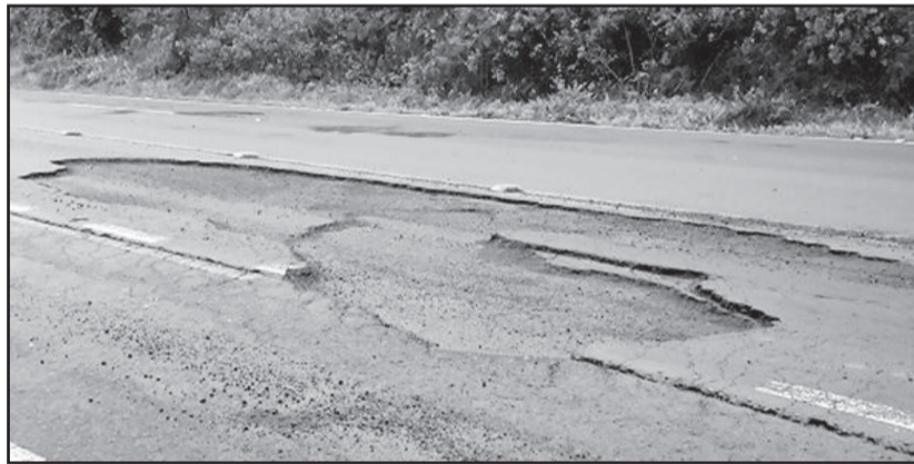
Falta de manutenção - período de chuvas ocasionou buraco de dois metros gerando transtornos na RSC-470 em Bento Gonçalves
