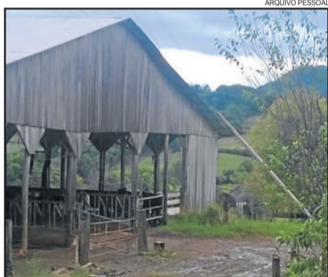
Poste caiu sobre galpão no interior de Colinas
