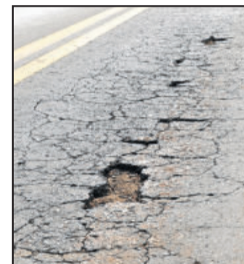
Buracos e rachaduras são comuns na Via Láctea
