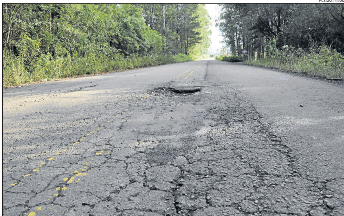
Buracos e rachaduras estão entre os problemas da rodovia
