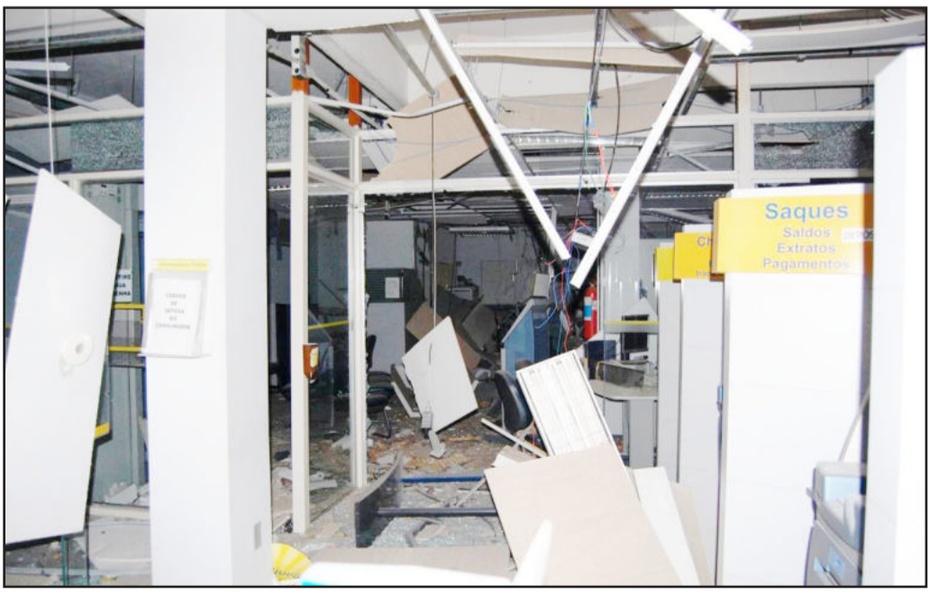
Explosão destruiu interior da agência
