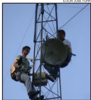
Antena de internet gratuita foi instalada no Parcão
