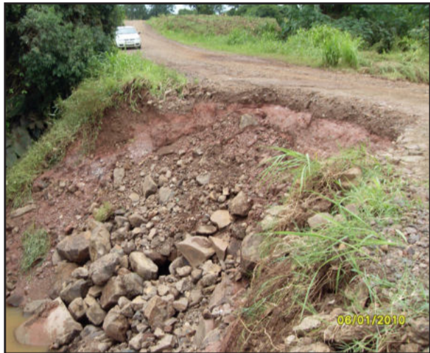
Danos na estrada da Cascalheira
