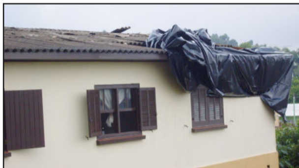
Residência de Eliane Röhrig foi uma das destelhadas em Canabarro
