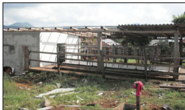
Sala de ordenha foi bastante destelhada
