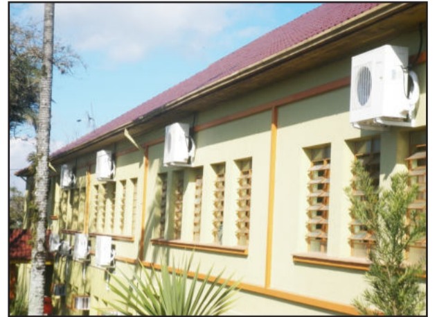
Colégio Teutônia climatizou suas 15 salas do prédio principal
