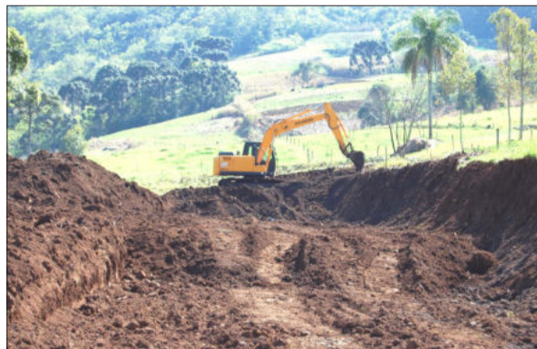
Apoio ao produtor rural na abertura de novos empreendimentos (no local da foto será erguido um novo aviário para 18 mil unidades)
