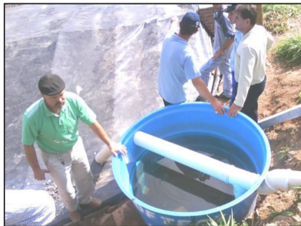
Sistema de filtragem antes de entrar na cisterna
