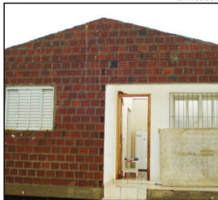
Casa, onde Anderson Wommer reside com a família, na Vila Esperança, em Teutônia, ficou completamente destelhada pela ação do vento ontem à tarde
