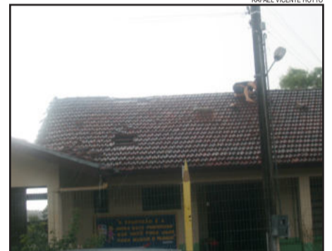
Telhado da Escola Guilherme Sommer, na Vila Popular, também foi danificado
