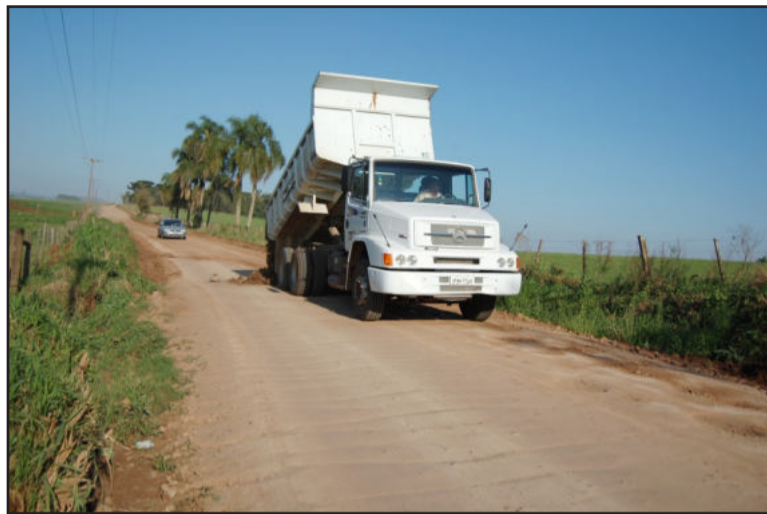
Estrada precisa de reparos constantes
