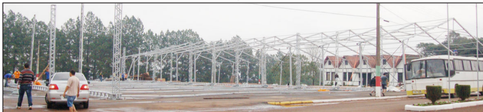
Segue a montagem da estrutura para receber a Festa de Maio, para os pavilhões da exposição comercial, industrial e de serviços
