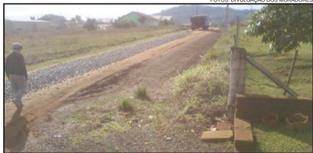
Colocação de brita não tem solucionado o problema
