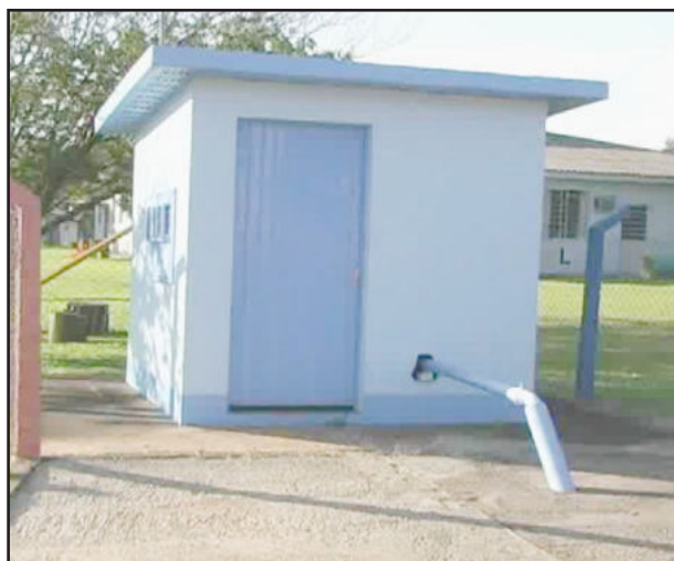
Poços Artesianos protegidos por casinhas padronizadas
