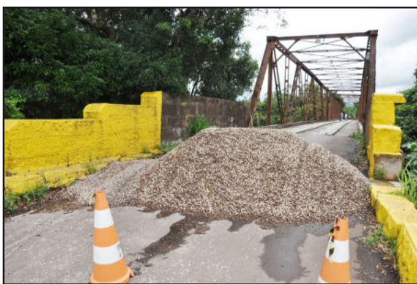
Ponte está interdita para o tráfego de quaisquer veículos
