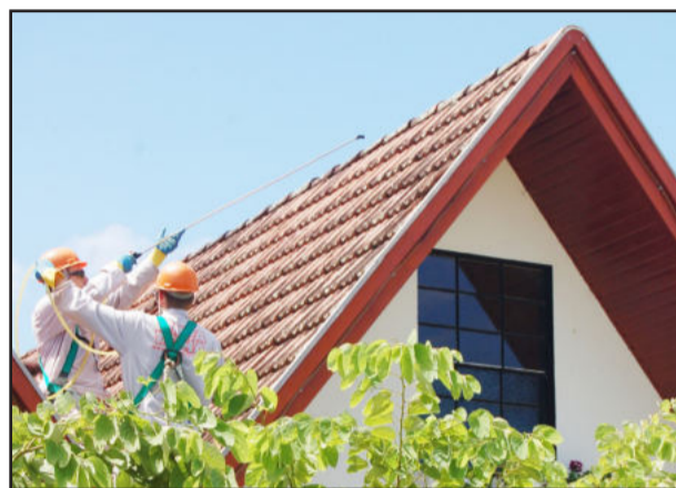
Limpeza do telhado do Centro Administrativo é inédita em prefeituras da região
