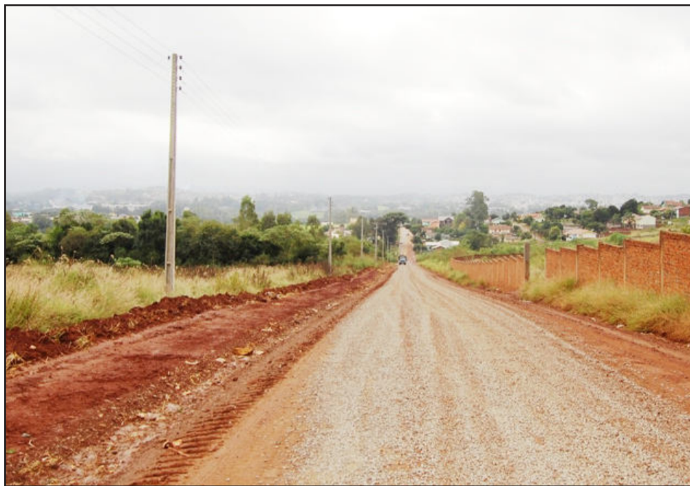
Na Rua Arnoldo Uhry, no Bairro Jardim do Cedro, foram investidos R$ 22.416,52 na extensão de rede de iluminação pública
