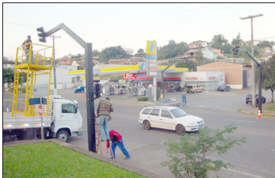
Semáforos funcionarão intermitente para alertar os motoristas sobre a mudança no trânsito
