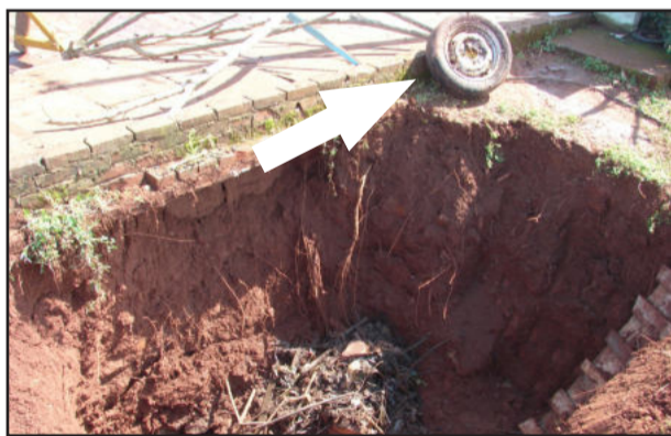
Roda com pneu estava no bueiro
