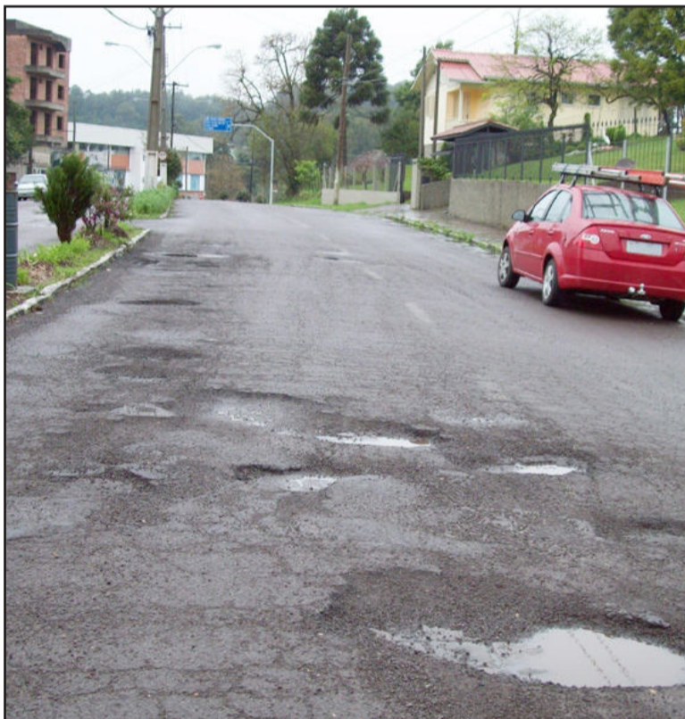
Buracos na Buarque de Macedo no Bairro Alfândega em Garibaldi
