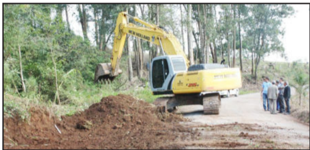
Empresa iniciou a terraplenagem para asfaltar a Estrada de São José da Costa Real
