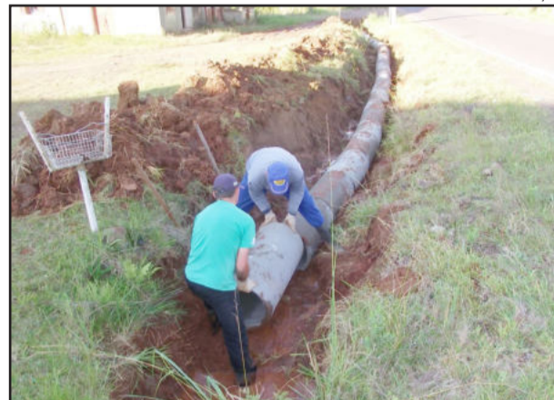
Rede de esgoto na Cidade Baixa
