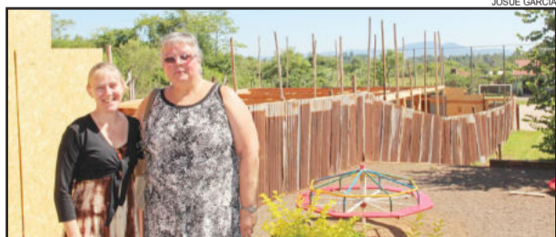
Diretora dos educandários Neidi Steiger Woiciechowski e vice-prefeita, Irene T. H. V. da Silveira acompanhando a obra de ampliação
