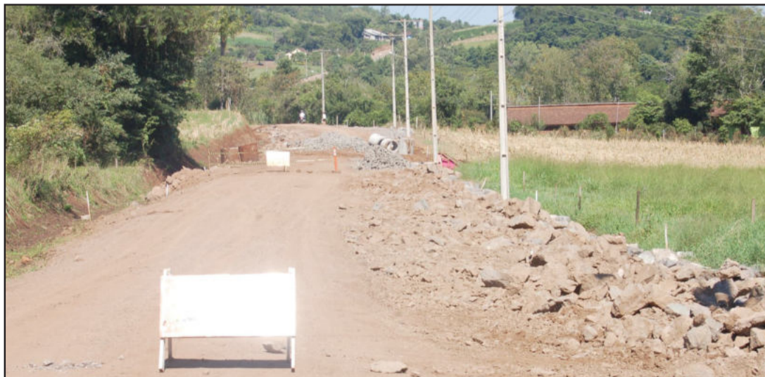
Colocação de tubulação e preparação da cancha são fases estruturais da obra
