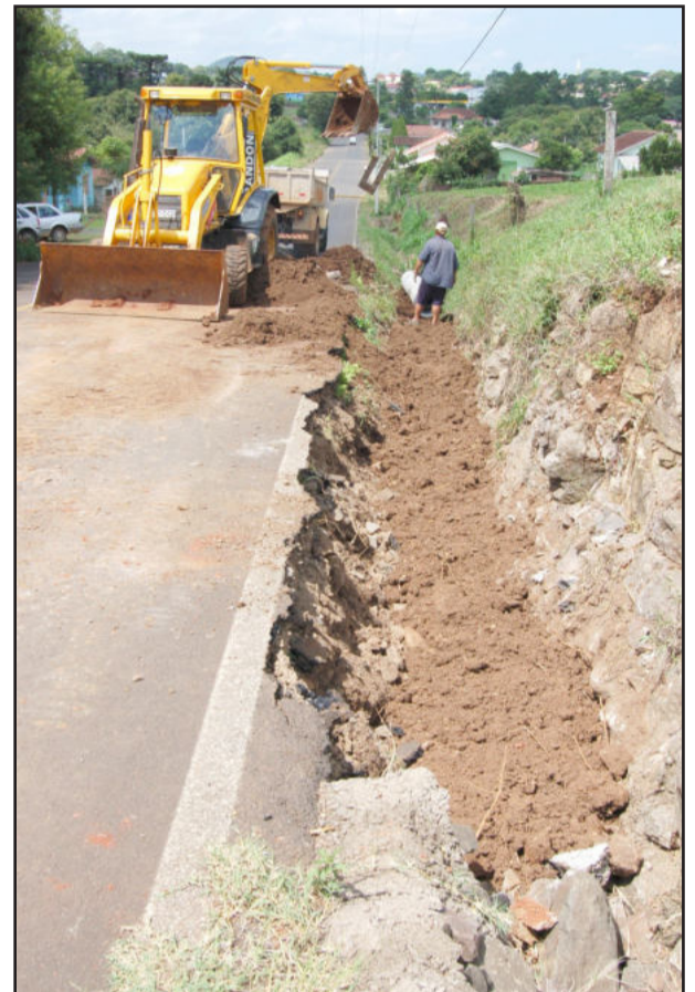
Lateral da Rua Maurício Cardoso, no Loteamento Weber, teve sérias avarias e foi recuperada pela Prefeitura
