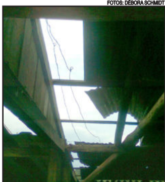
Galpões foram destelhados
