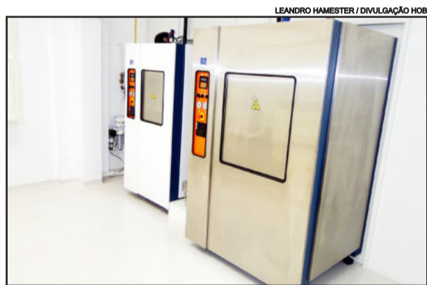
Central de Material Esterilizado foi inaugurada em setembro de 2011, com a instalação de duas novas autoclaves
