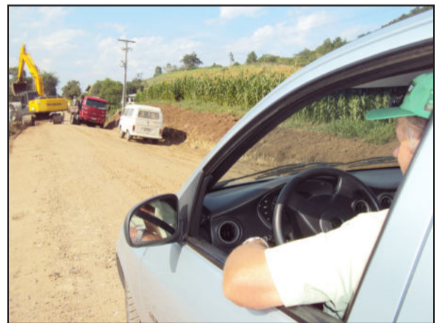
Via que receberá asfalto é fundamental para escoar a produção de frango, poedeiras, suínos, leite e outros
