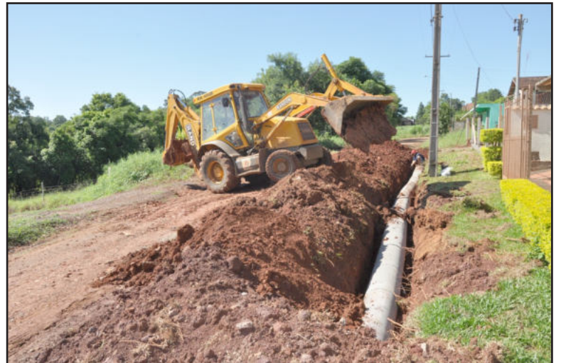
Rua Miguel Paulus com canalização pluvial
