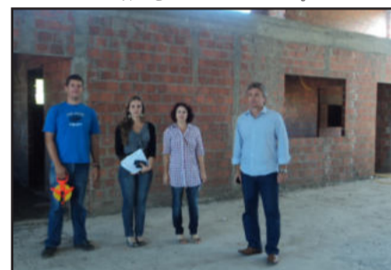
Administração vai dar andamento às obras do ginásio da EMEF 24 de Maio no Loteamento 8
