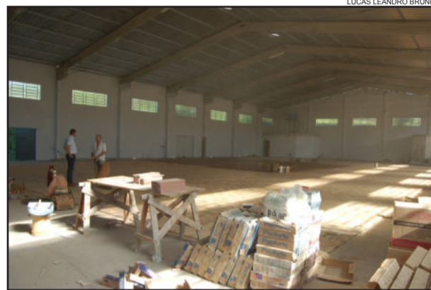
Reta final nas obras de construção do ginásio da EMEF 24 de Maio, no Loteamento 8
