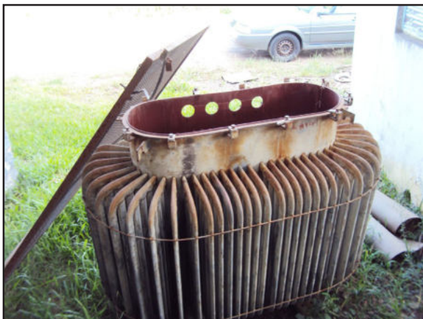
Transformador foi destruído para retirada de fios de cobre
