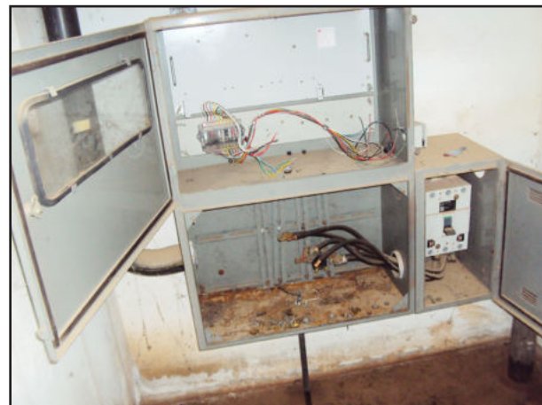
Caixa de luz também foi danificada
