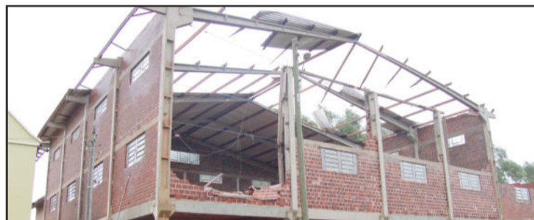
Ginásio teve paredes e telhado destruídos
