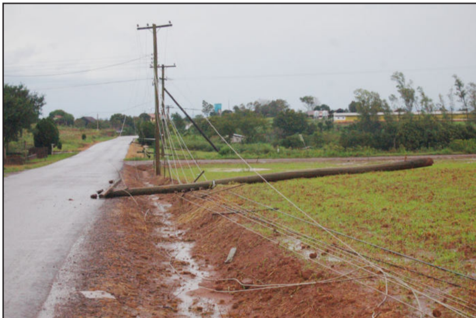
Redes elétricas interromperam o fornecimento de energia por bastante tempo
