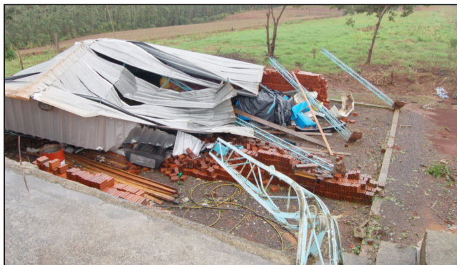
Na residência de Darci João Palm, estrutura metálica foi retorcida pelo vento
