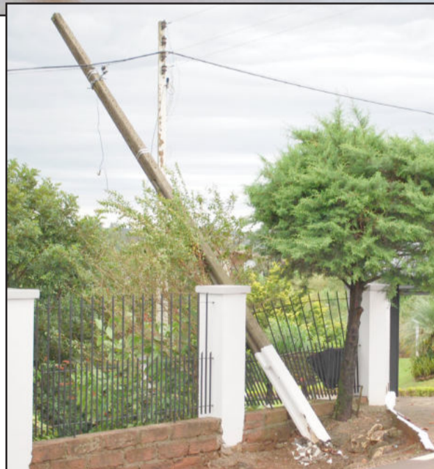
Postes caídos em vários pontos
