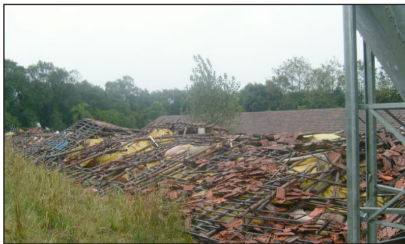
Chiqueirão destruído na propriedade de Oterno Sprandel
