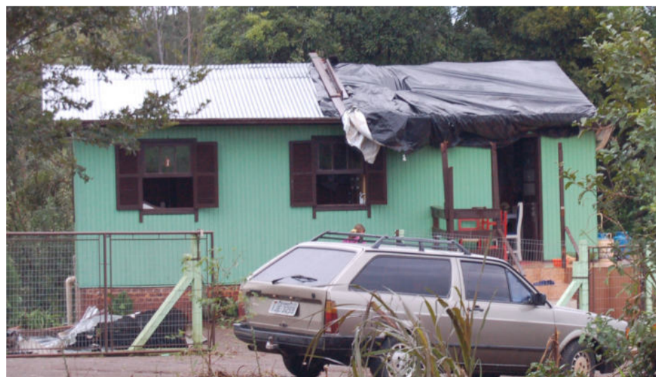
Residências destelhadas foram provisoriamente cobertas com lonas
