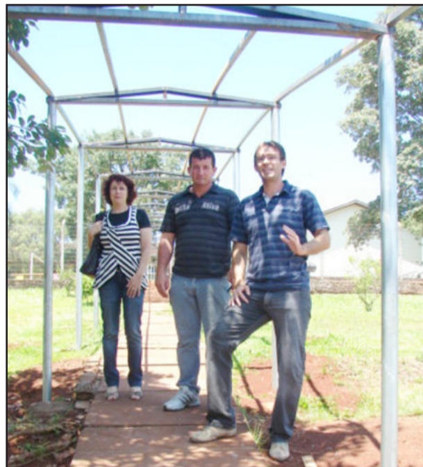
Na Escola Guilherme Sommer é construída uma cobertura para interligar os prédios
