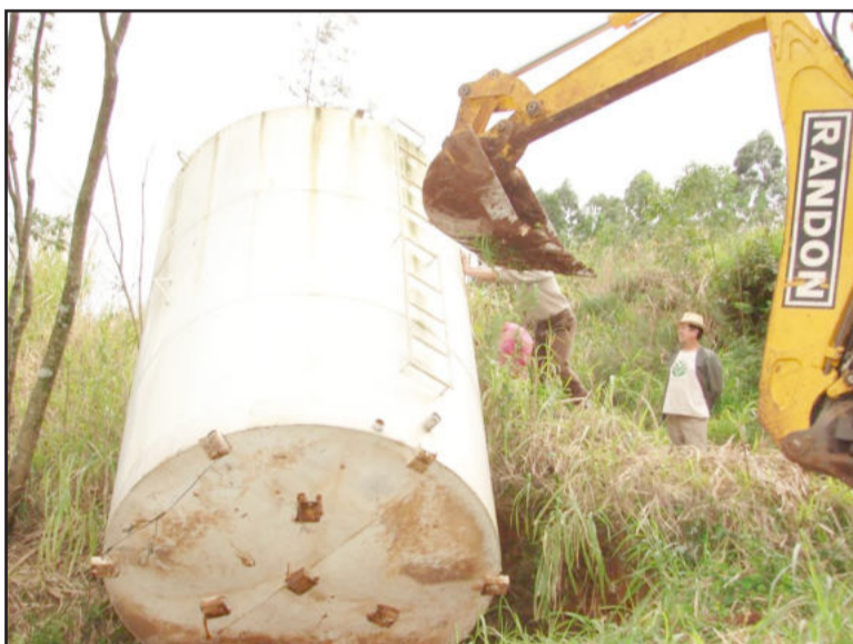
Antigo reservatório era de metal e tinha capacidade para 16 mil litros
