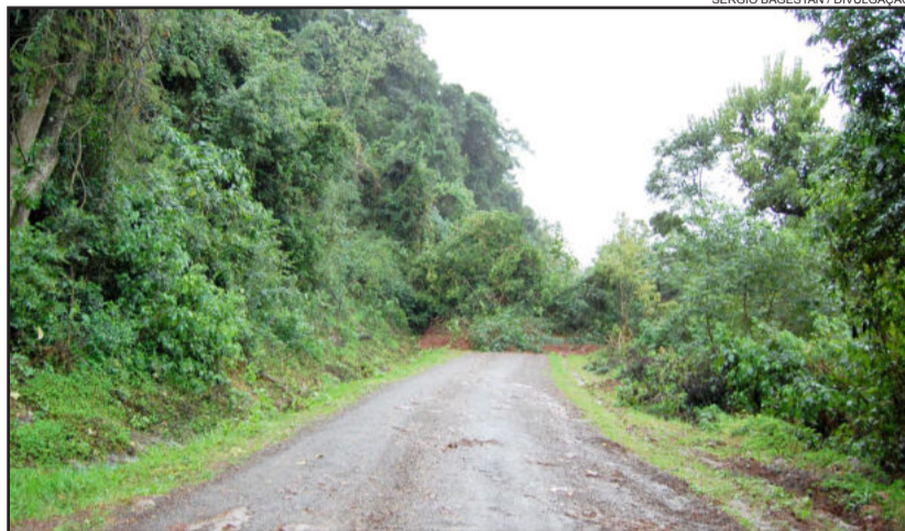
Deslizamento interrompe a estrada Boa Vista 37
