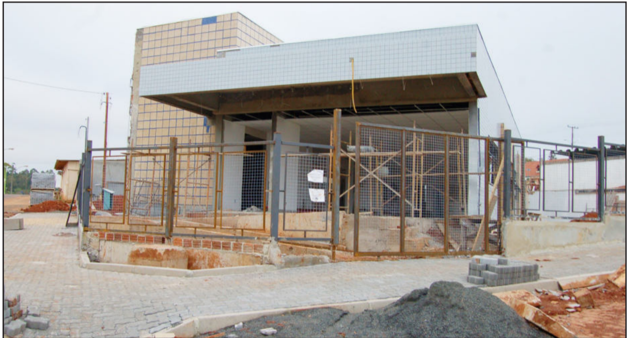
Obra do prédio próprio da Agência do INSS entra na fase de acabamentos
