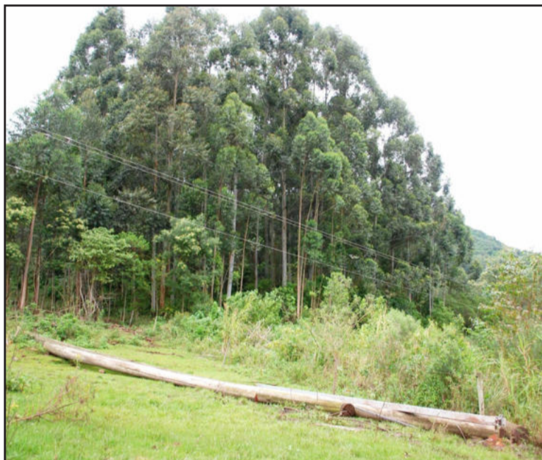
Temporal atingiu parte da estrutura de 69 mil volts
