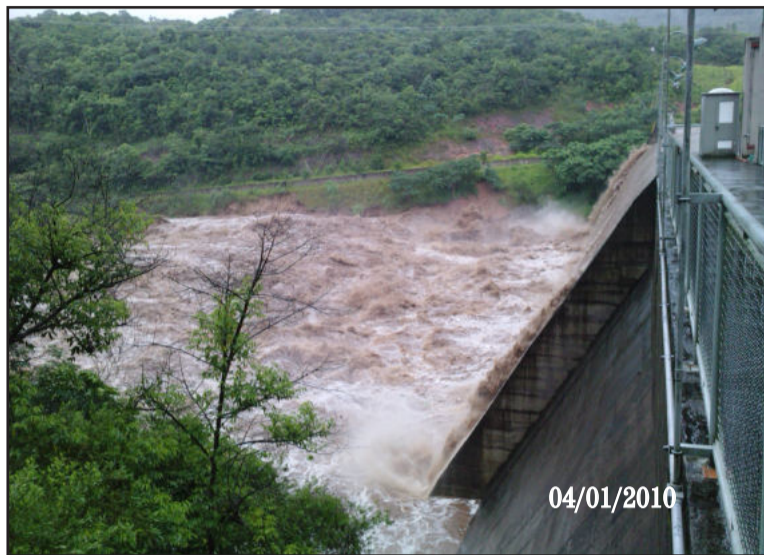
Ápice da enchente do Forqueta junto à barragem da PCH Salto Forqueta
