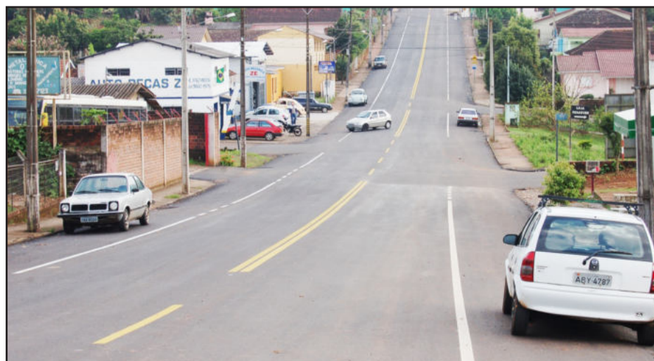
Rua Carlos Arnt ficou com visual moderno e muito bonita após capeamento. Ainda está em construção a nova calçada
