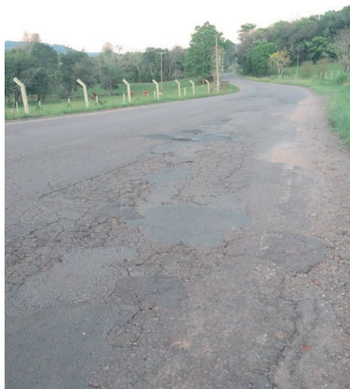
Enquanto obras não acontecem, rodovia segue se deteriorando
